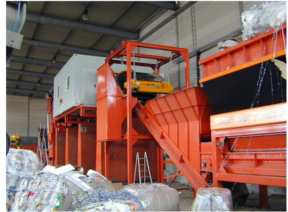
Abb. Kompletanlage von der Seite
